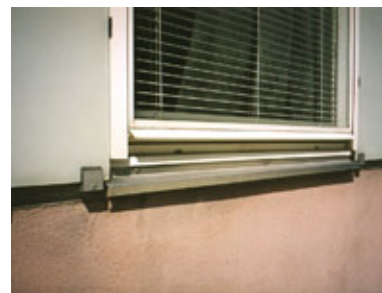
Fasaddetalj som visar nya clips och fönsterbleck samt socklarnas urlakade blekrosa puts.
